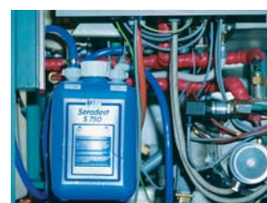
Dispositivo di trattamento acqua generatore vapori
